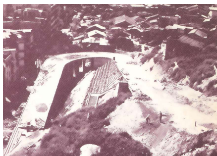
修建中的明愛醫院永愛道（60年代初），永愛道最初名為慈善道
